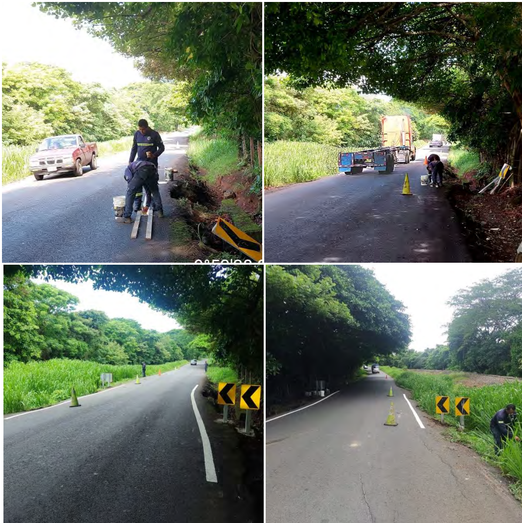
Pozón, señalización horizontal y vertical en zona de riesgo
